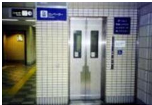
エレベーターの設置状況
