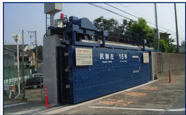
【鉄扉の電動化】平成 26 年度完了
