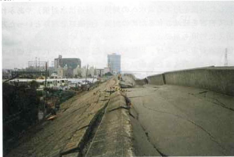
H7.1 兵庫県南部地震による堤防の崩壊（淀川）
