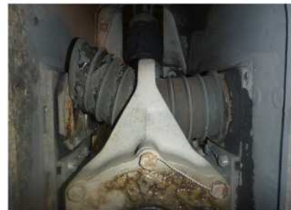
ゴムブロックの外れ
