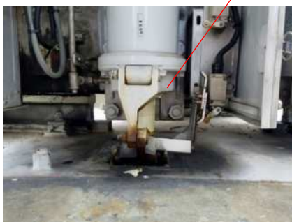
ロックシリンダの損傷
