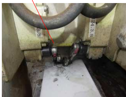
リミットスイッチの損傷
