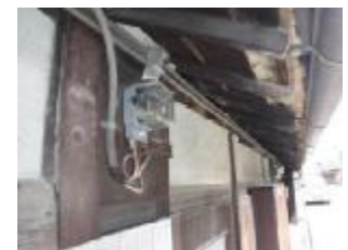
軒下配線 整備事例
