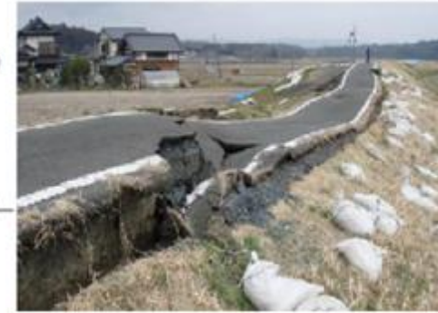
写真—大規模な堤防損傷の例(土堤)
