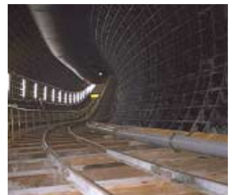
関西電力の地中送電線 (大深度地下の活用事例) 40mより深い地下空間を 活用している
