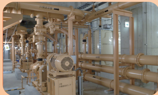
⑥汚泥圧送ポンプ
