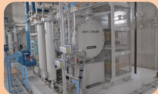
④オゾン発生装置
