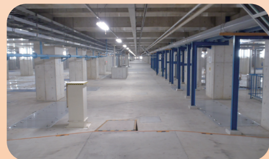
①水処理施設全景
