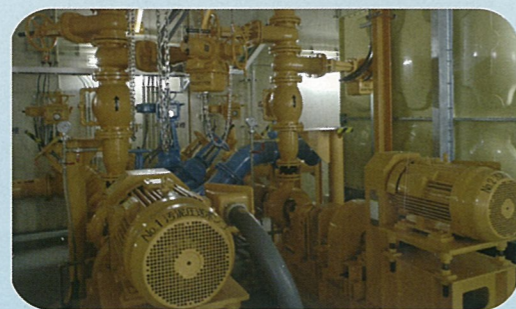
⑤汚泥圧送ポンプ
