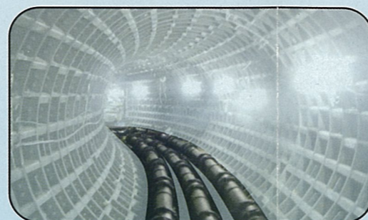
⑥送泥管 (工事中)
