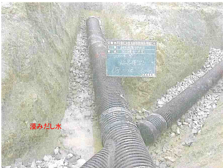
③地下排水管の敷設時の床堀で浸みだし水が出現
