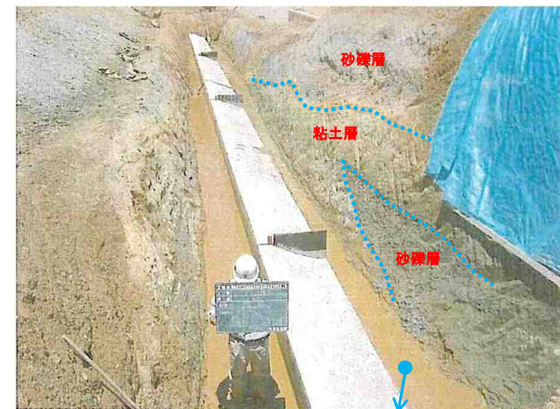
⑤ 床掘後にベース打設までの間に砂礫層から浸みだし水が発生。
