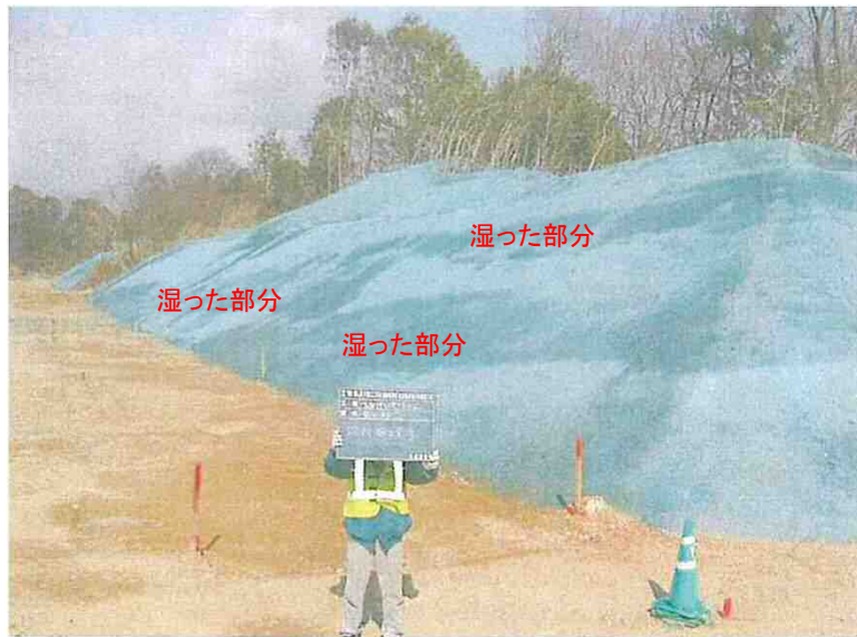
①8工区掘削のり面に植生吹付工が実施されております。湿った範囲出現。
