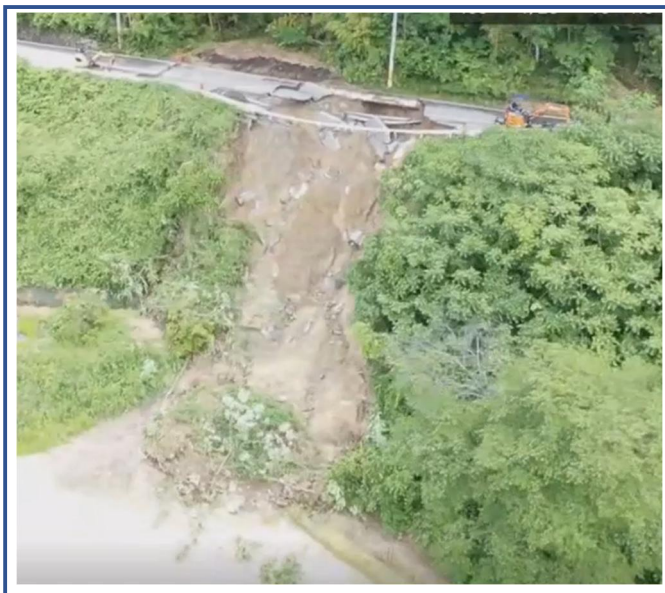
被災写真(令和8年6月3日撮影)
