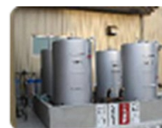
大型貯蔵タンク
