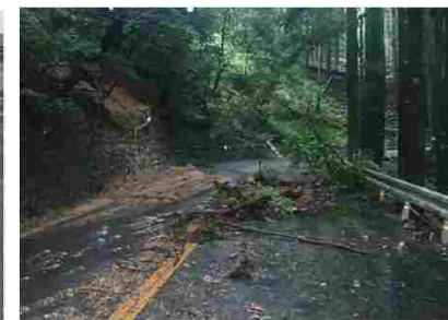
(例) 法面崩落、倒木
