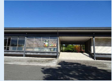
3号棟の経年劣化
