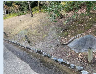
②水循環システムからの漏水
