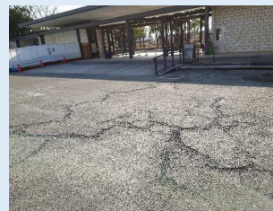
舗装の亀裂等
