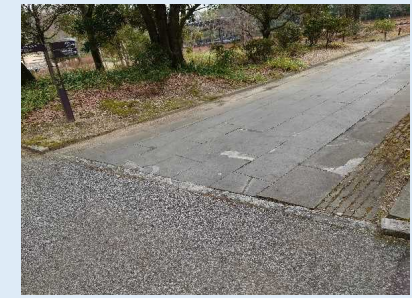
③園路の舗装劣化
