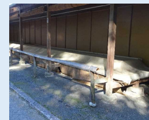
便益施設の柱劣化
