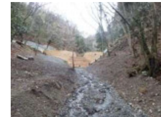
渓流沿いの危険木の除去
