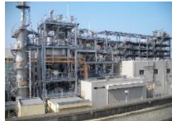
写真 18 省エネ機器の例 (過給式焼却炉)
