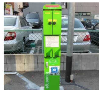
図 4 - 3 - 2 電気自動車の充電設備
