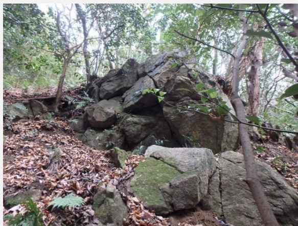
道路法面上部の危険な状況
