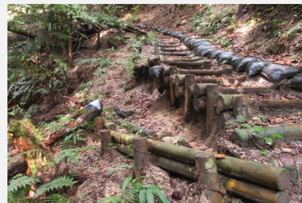
歩道の路肩部が崩落（路線全体を閉鎖中）
