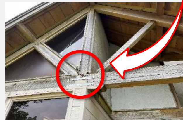
梁柱が腐朽しており、構造自体に影響がある便所
