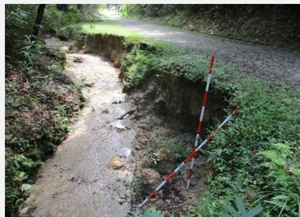
管理車道の路肩部が洗堀され崩落 (カラーコーン等を設置中)
