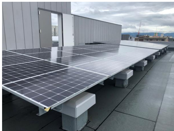
太陽光パネル
