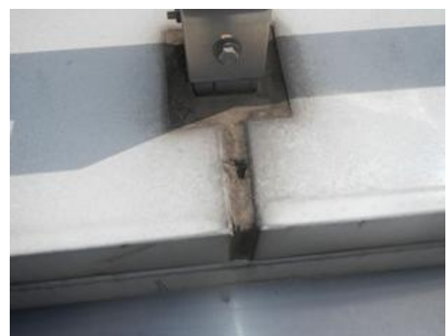
シール材の劣化
