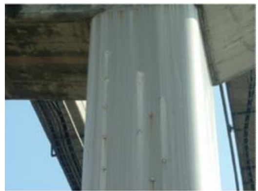
耐震補強材の劣化
