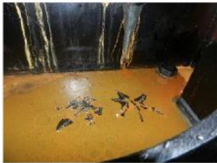
箱内部の滞水
