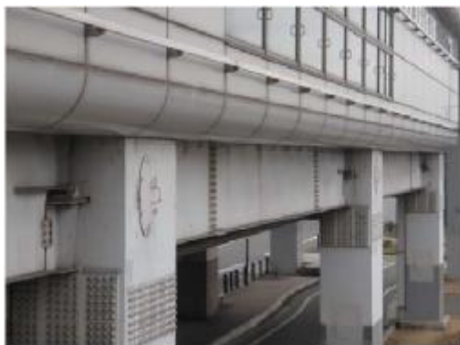
外壁の塗膜の劣化
