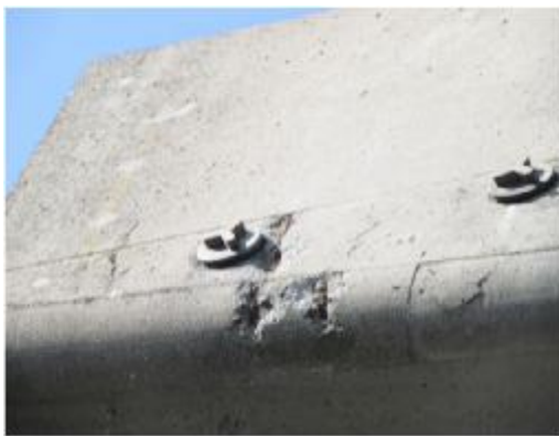
剥離・鉄筋露出
