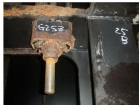
支承アンカーボルト受けの腐食
