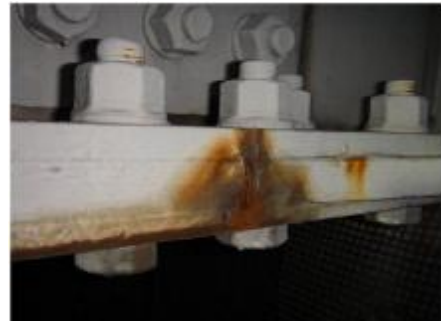
添接部の局所的な腐食
