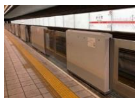
〔可動式ホーム柵の整備〕
