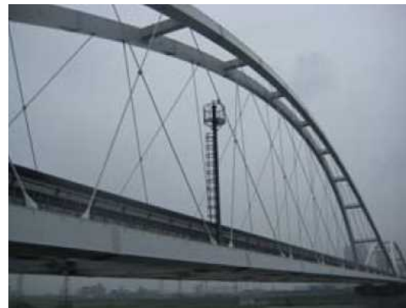
淀川橋梁風速計
