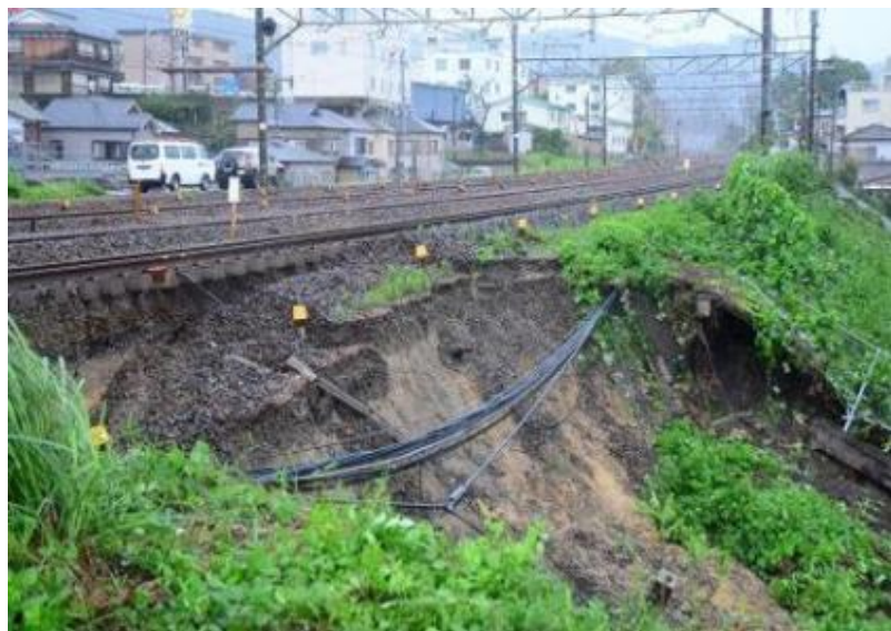
線路脇の盛土崩落
