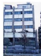
阪神大震災の被害にあったビル(3階部分がぶれていました)
