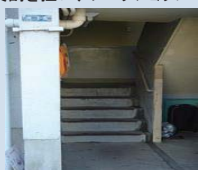
(共用廊下等への手摺設置例)
