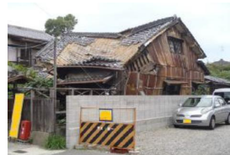
【Cランク】柱の腐朽、破損又は変形が著しく、崩壊の危険があり、建築物の除却が必要なもの
