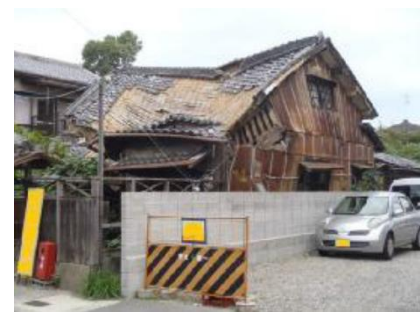
【Cランク】柱の腐朽、破損又は変形が著しく、崩壊の危惧があり、建築物の除却が必要なもの
