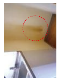
冷蔵庫の後面面の黒ずみ(雑気ヤケ) 通常の使用による損耗⇒ 貸主負担
