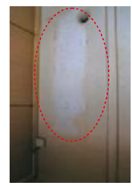
エアコン(借主所有)設置による壁のビス穴、跡 通常の使用による損耗⇒ 貸主負担
