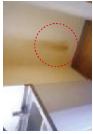
冷蔵庫の後面面の重さ(電気ヤケ) 通常の使用による損耗⇒ 貸主負担
