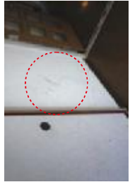
壁への落書き等の変色による剥離⇒ 借主負担
