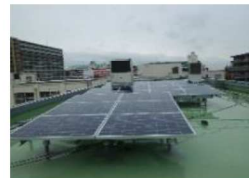
屋上に設置した太陽光発電設備
