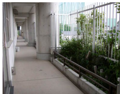
普通教室ベランダ部分屋上緑化
