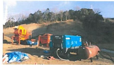
写真 1-1 プラント全景
