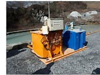
濁水プラント
