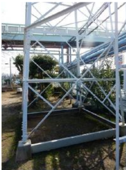
電気設備への地震対策
