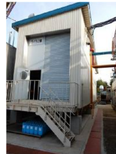
ボイラ設備への地震浸水対策
