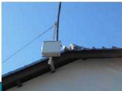
PHS場内通信用 アンテナ
