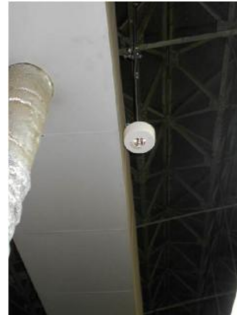
非常灯（停電時に自動点灯）
