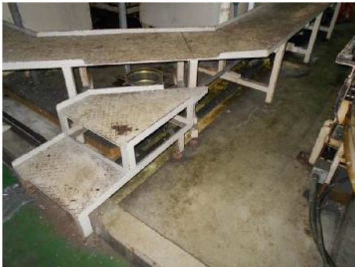
めっき施設の周囲を防液堤で囲う (防液堤の内部の床は地下浸透防止のため、コーティングを実施)
