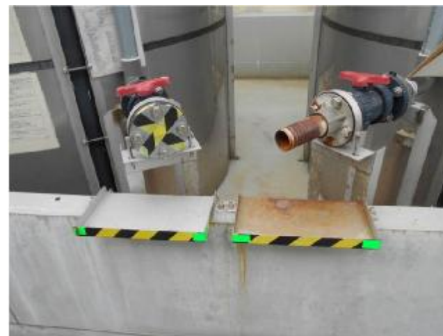
タンクに接続する配管の つなぎ目に受け皿設置
