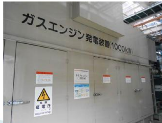
コジェネレーションシステム(ガスエンジン発電装置)
