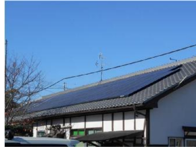
太陽光発電設備
