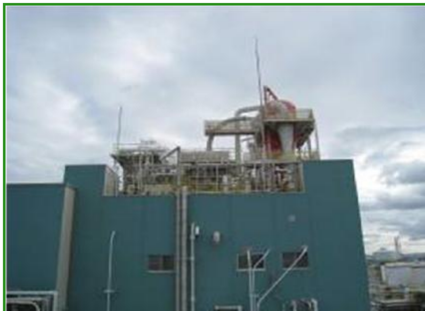
排ガス処理設備
