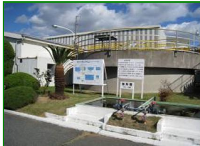
排水処理設備
