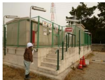
非常用発電設備のかさ上げ
