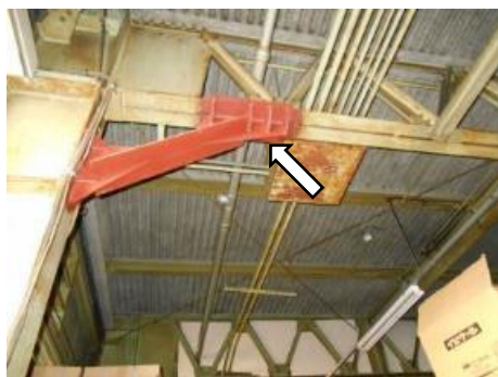
ブレース（建屋内）
