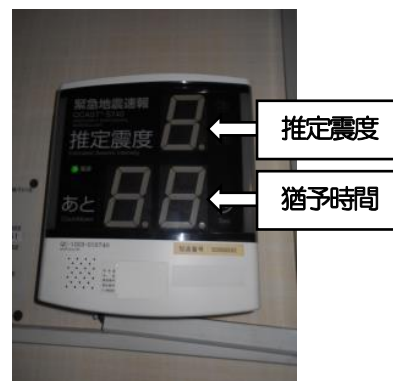
緊急地震速報表示装置
