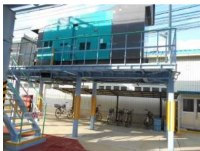
非常用発電設備のかさ上げ
