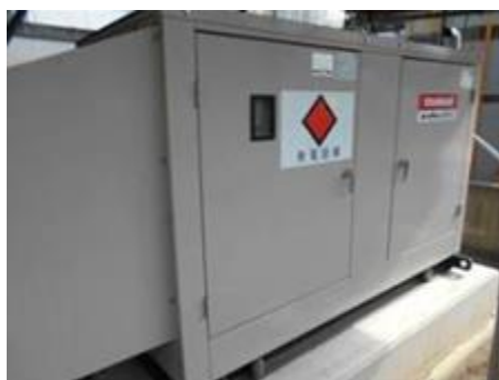
非常用自家発電施設
