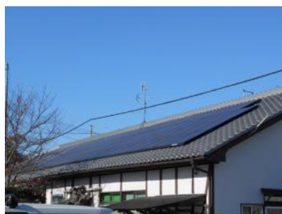
太陽光パネル
