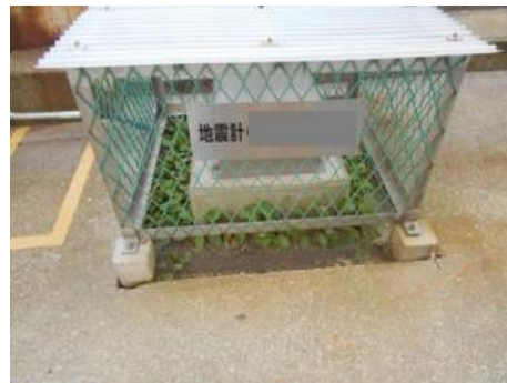
緊急遮断弁と連動する地震計
