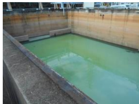
貯留槽（最終放流口前）
