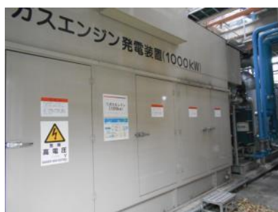
コージェネレーションシステム
