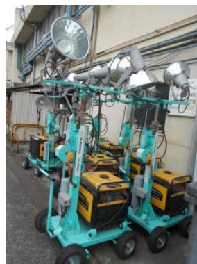
非常用発電機を併用した投光機
