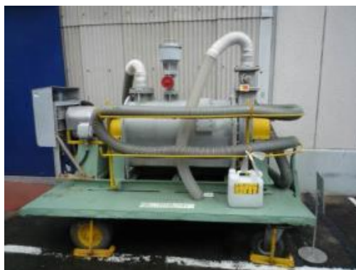
ガス吸収装置
