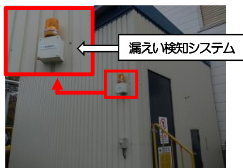
漏えい検知システム
