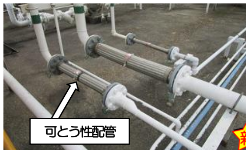
地上配管（一部、可とう性配管）
