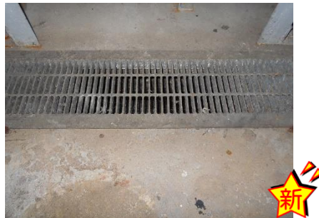
側溝（流出防止溝）
