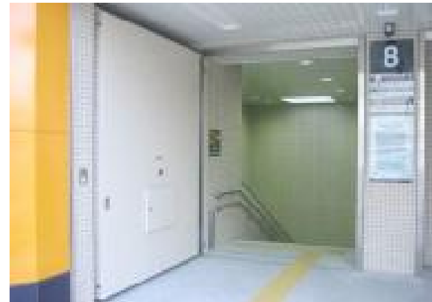
止水扉の設置事例
