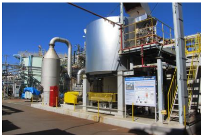
蓄熱式脱臭炉
