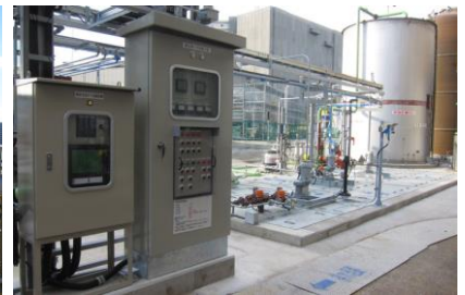
排水処理設備
