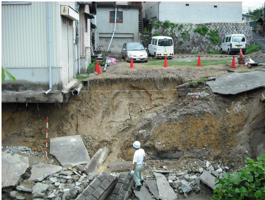
平成23年被災箇所 冬堂橋下流右岸
