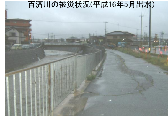
百済川の被災状況(平成16年5月出水)
