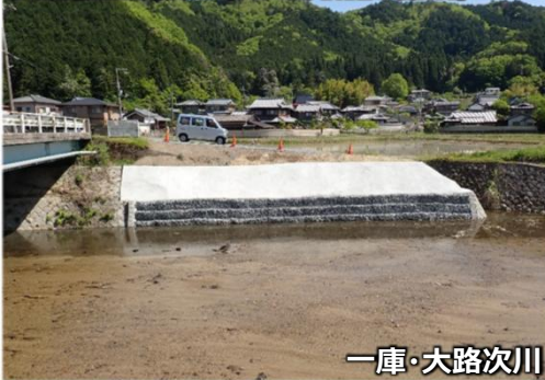
災害復旧 (R6年11月護岸崩落)
