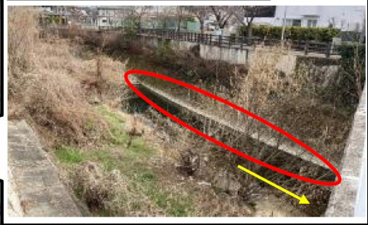
千里川R4-1 河床の洗堀
