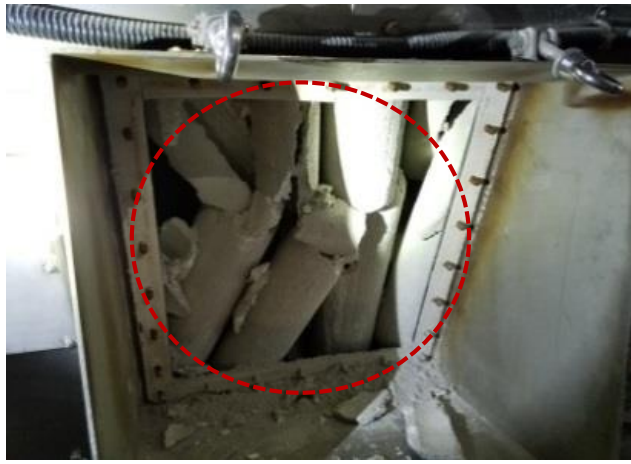
下水道焼却設備破損
