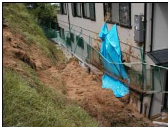
写真参 1-3 がけ崩れ災害 (H16・畑(8)地区)
