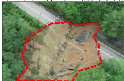
平成30年7月豪雨による 道路法面被害(国道173号)
