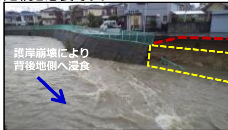
令和元年8月豪雨による 河川護岸被害(東除川)
