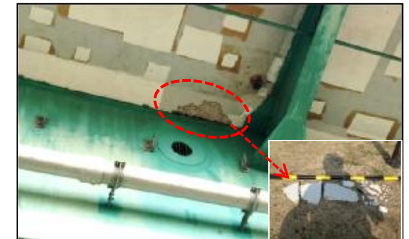
モルタル片の剥落
