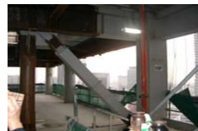
鋼材系ダンパーの設置例
