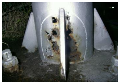
腐食が表面まで及んだ例
