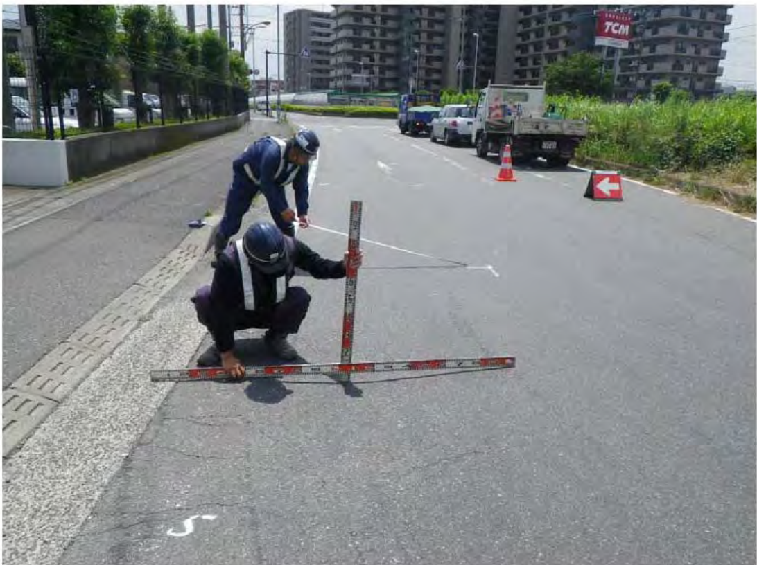
図3-7 陥没危険箇所が存在する場合の路面の変状状況写真
