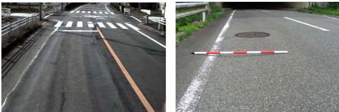
図3-5 わだち掘れ発生状況写真(2)
