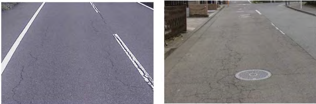
図3-2 ひび割れ発生状況写真(2)
