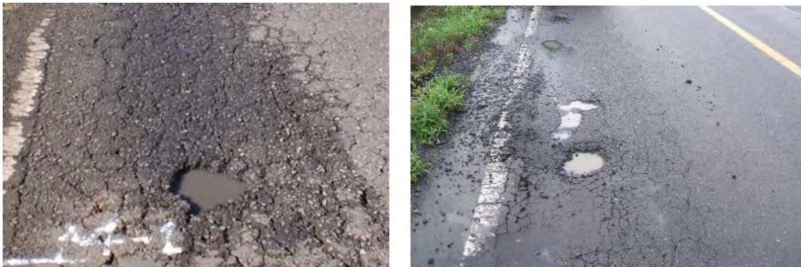
図3-8 ポットホール発生状況写真
