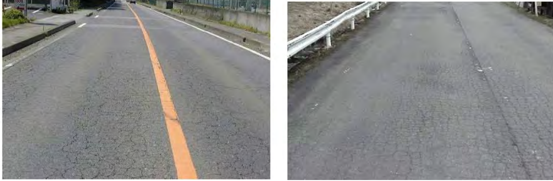
図3-3 ひび割れ発生状況写真(3)
