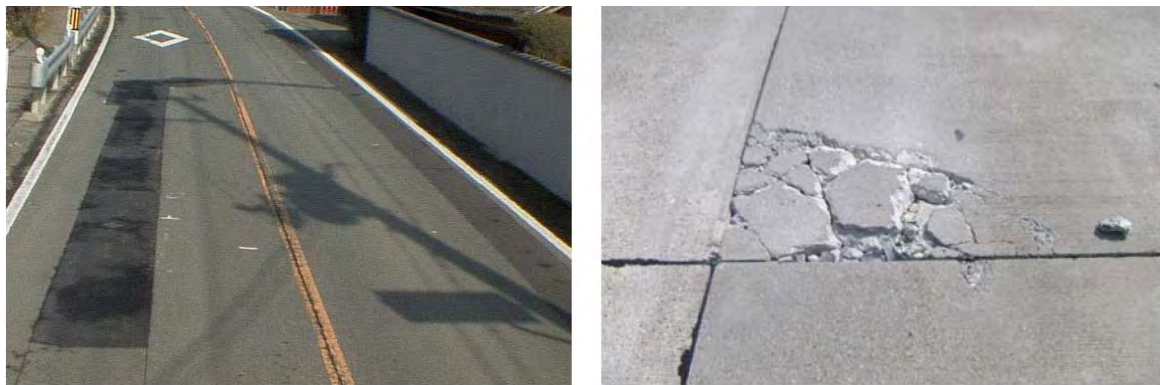
占用復旧跡の沈下
