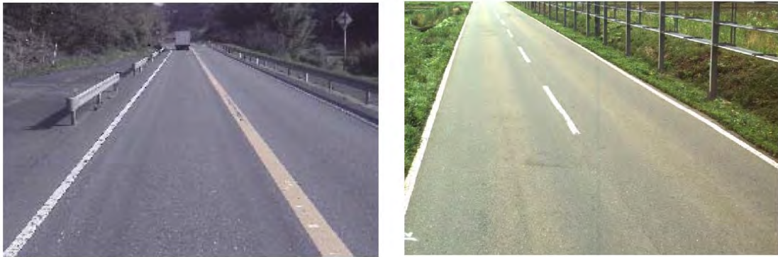
図3-4 わだち掘れ発生状況写真(1)
