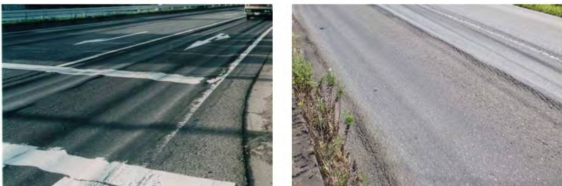
図3-6 わだち掘れ発生状況写真(3)
