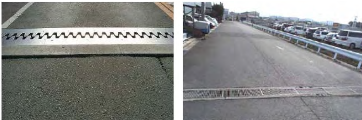
図3-9 段差発生状況写真
