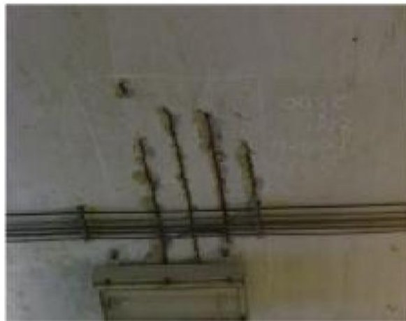
付写真-2.2 材腐食の例
