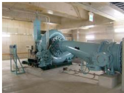
長居水力発電設備
