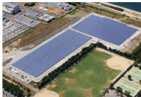
南部水みらいセンター 太陽光発電プラント
